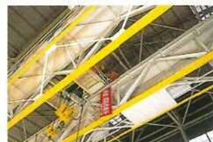
天井クレーンの法定点検
